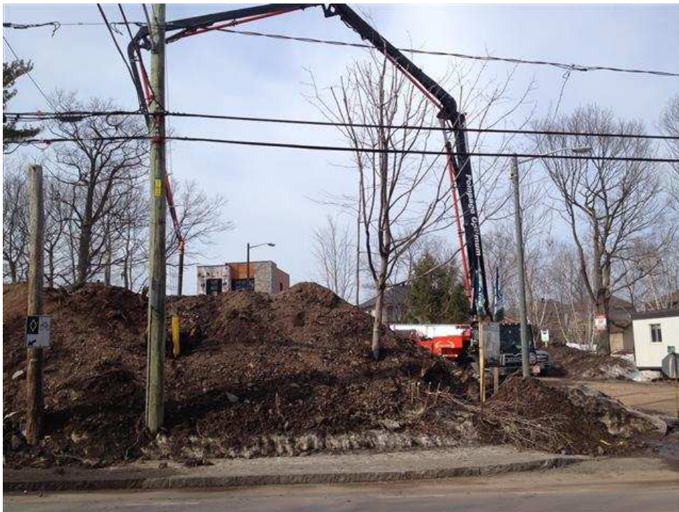
Bande boisée résiduelle en avril 2014 sur le côté nord du chemin Saint-Louis entre l'avenue des Compagnons et la rue Valentin : les troncs des arbres à conserver sont recouverts par du matériel d'excavation ce qui cause des blessures multiples, souvent mortelles, aux troncs et aux racines lors du ramassage du matériel d'excavation.
